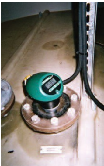
IMP نصب شده در مخزن همزن
